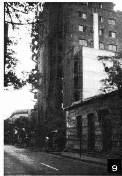
IMAGEN DE DETERIORO FISICO
